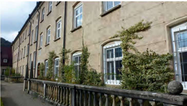
Der Südflügel wartet noch dringend auf seine Sanierung.
